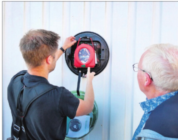
MONTERER: En elektriker fra Kjeldal Elektro på Stathelle monterer hjertestarteren, mens Rolf Heimdal fra Langesund rotaryklubb ser på.
